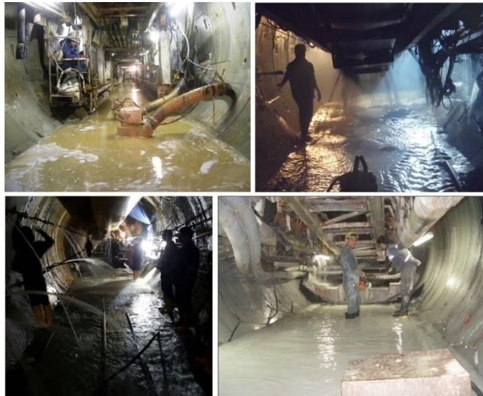
شکل ۳. هجوم آب زیرزمینی در قطعه ۱ و ۲ تونل قمرود.
