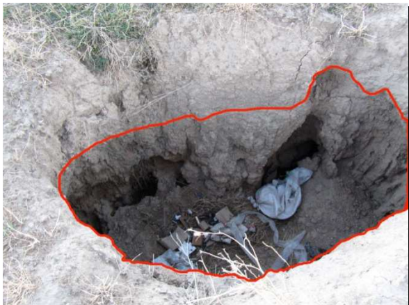
شکل ۲. فروچاله در اطراف سد گلستان ۱
