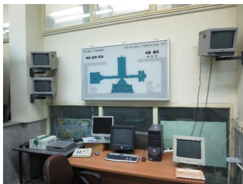
ج - اتاق کنترل
