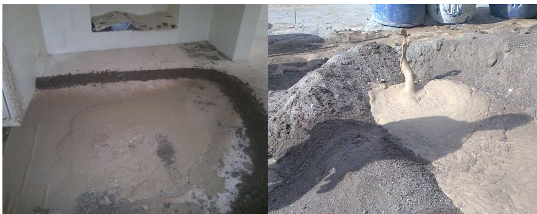
شکل ۱۲. نفوذ دوغاب بتونیت و خروج هوای تحت فشار به داخل منزل مسکونی در حین عملیات هایپرباریک (سمت چپ) خروج فوم از سطح خیابان در حین حفاری (سمت راست)
