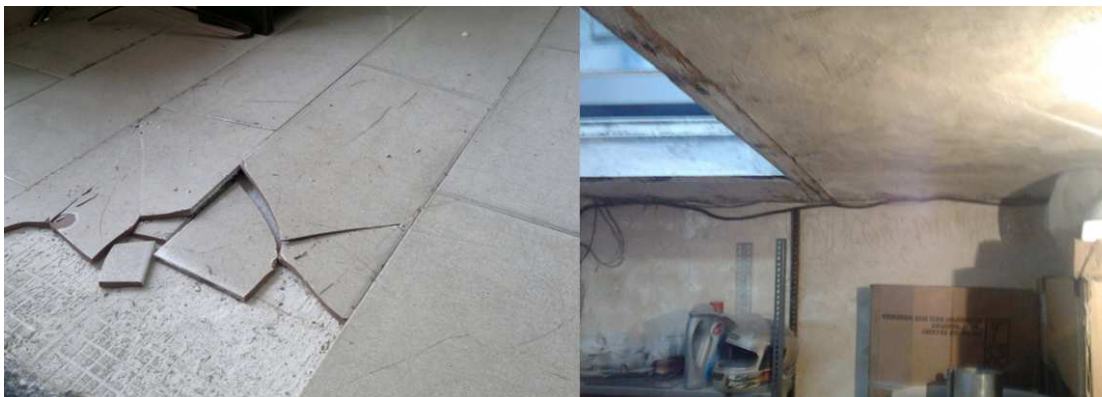
شکل ۶. بالازدگی سرامیک کف طبقه همکف بالای زیرزمین در اثر لرزش (سمت چپ) و سقف طبقه زیرزمین آن (سمت راست)
