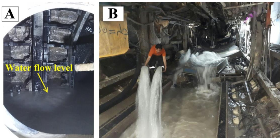
شکل ۱۱. A- دید از دریچه چمبر: مترآز ۵۶۲۰، نمایی از هجوم شدید آب از درز و شکاف توده سنگ آهکی تله زنگ و پُر شدن محفظه چمبر از آب و مصالح سنگی. B- نصب پمپ آبکش و هدایت جریان آب در شیب مثبت تونل.
